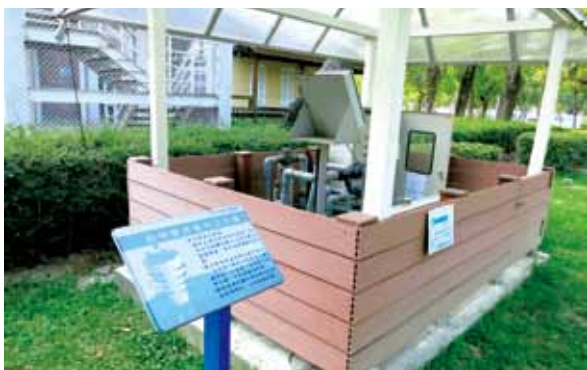
南館雨水回收設施
