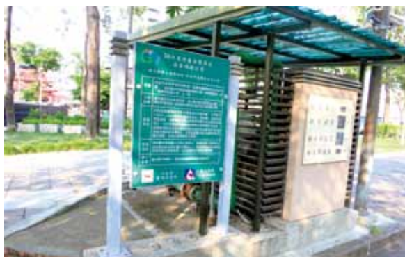
北館雨水中水回收設施
